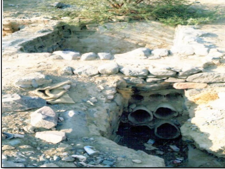
(لوحة 5) عين الخير ويظهر فيها أنابيب نقل المياه
